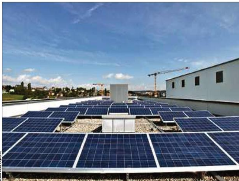
Installation photovoltaïque de 18 000 mètres carrés sur les toits de l'EPFL. La centrale, réalisée en collaboration avec Romande Energie, possédera une puissance maximale de 2 mégawatts crête. ARCHIVES
