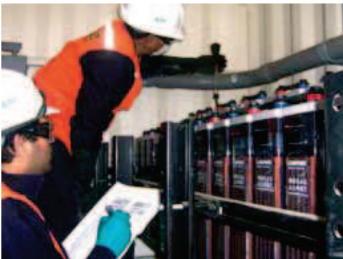
Früher wurden für größere Speicher meist Bleiakkus miteinander verschaltet. Mittlerweile gibt es aber auch Lithiumspeicher im Containerformat.
